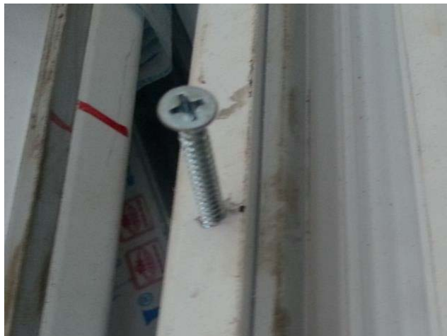
Foto 11. Tornillo pelado de un perfil de PVC con refuerzo metálico
