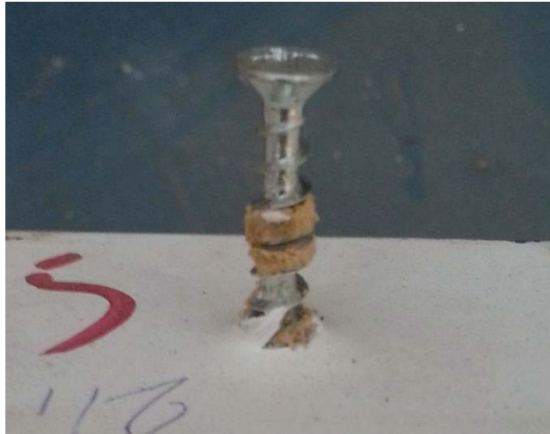
Foto 10. Tornillo pelado de un perfil de PVC con refuerzo de composite con base de Penwood
